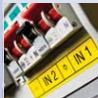
Elosztó szekrények és kapcsolópanelek
