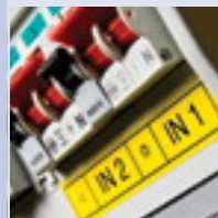
Elosztó szekrények és kapcsolópanelek
