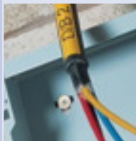
Kábelcsatornák és szigetelések
